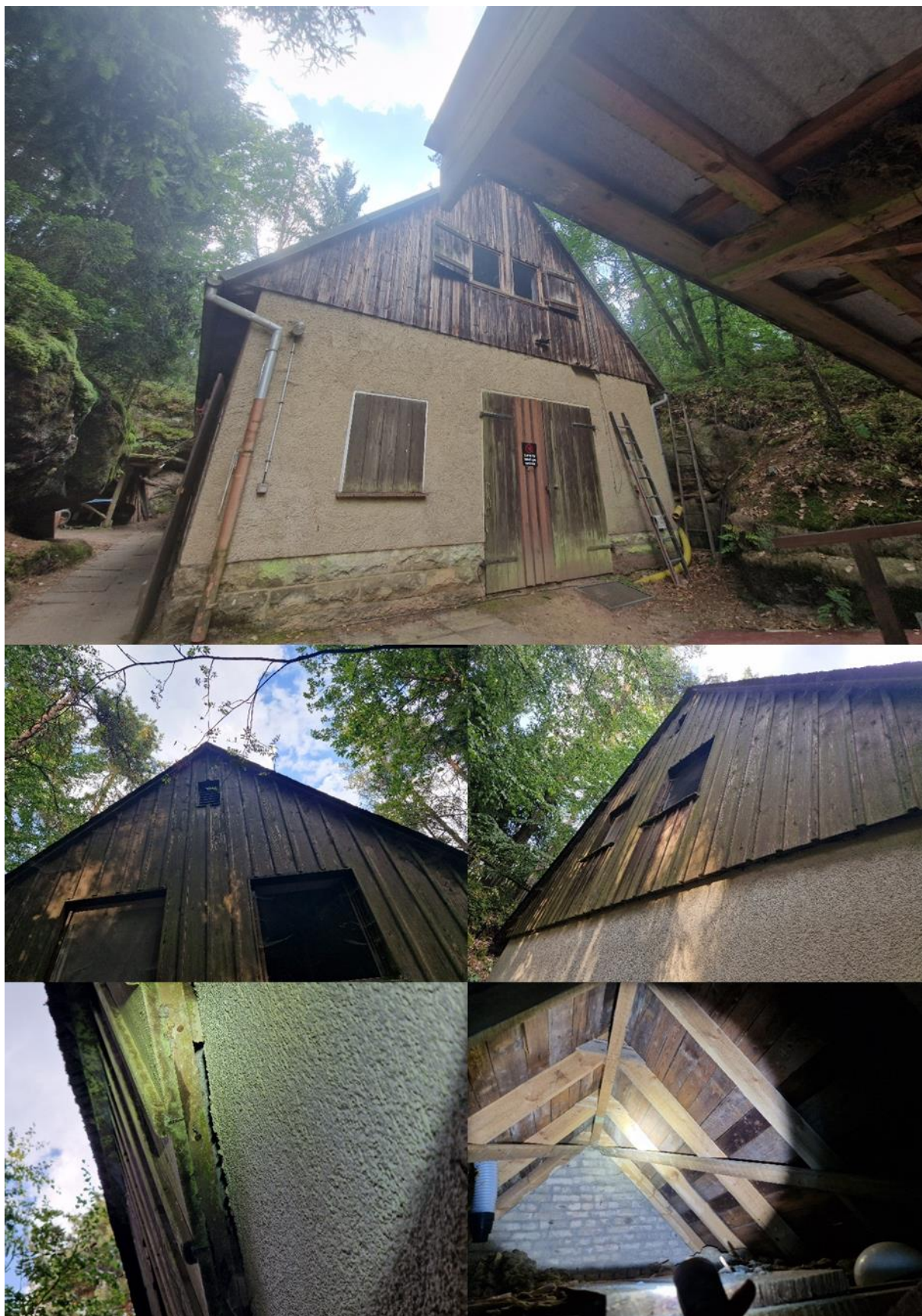
Abb. 13: Aufenthaltsgebäude/Werkstatt mit Spaltenversteck an Holzverkleidung und Dachboden
