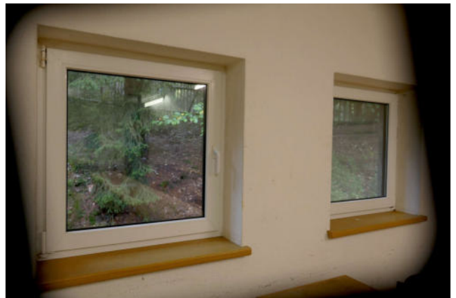
Bild 41: Im hinteren Gebäudeteil zu entsorgende Kunststoff- Fenster
