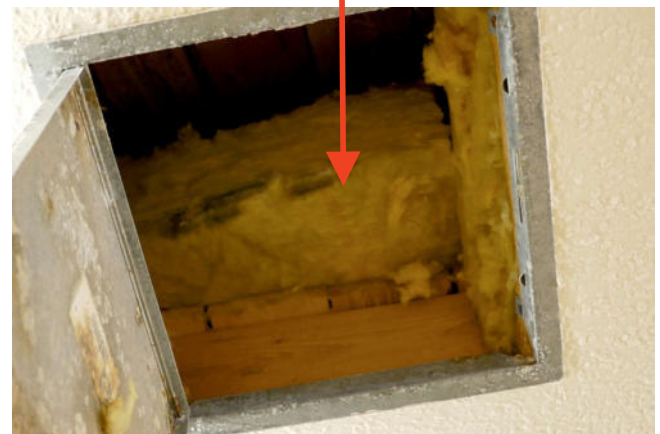
Bilder 38 und 39: Auf Unterhangdecke vorhandene gelbe Mineralwolle
